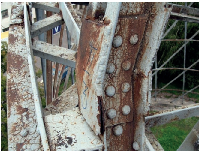
Рис. 3. Разрушение сварных швов в местах приварки накладок на узлы сопряжения стоек первой и второй секций. Фото авторов статьи
