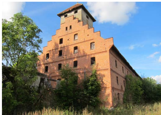
Гусево. Амбар в усадьбе Гросс Гни. Арх. не установлен. Первая пол. XX в.
