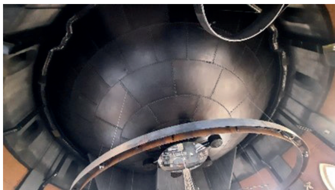
Рис. 7. Фрагмент дна резервуара водонапорной башни. Инженер В.Г. Шухов. Фото автора статьи. 2024 год
