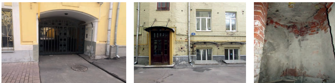
Рис. 3 8 . Фотофиксация разрушений исторического здания на территории ОКН до реконструкции (Знаменский переулок, 4)
