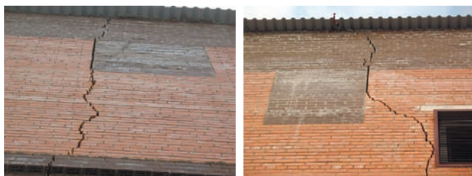
Рис. 1. Сквозные трещины в стенах подстанции
