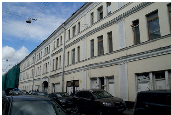
Москва. Типичный средовой дом конца XIX века. Фундаменты просели, перекрытия сгнили. Требуется существенная перестройка, поскольку в подобном виде дом использовать нельзя. Что делать? Сносить или заменить похожим новоделом?
