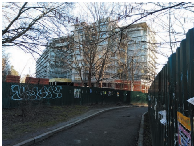
Рис. 6. Строящийся многоэтажный жилой дом на территории, прилегающей к Калининградскому проспекту. Фото В.И. Пустовгарова. 2020 год
