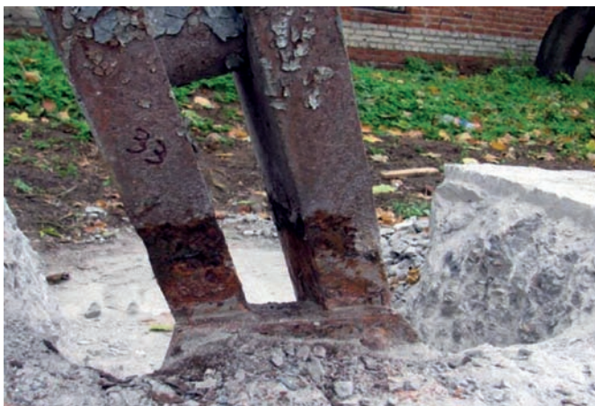
Рис. 2. Усиление коррозии в стойках первой секции в области их контакта с бетоном омоноличивания. Фото авторов статьи
