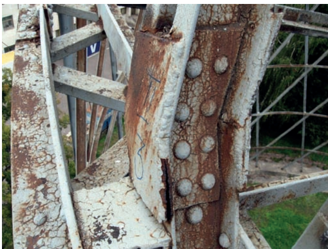
Рис. 3. Разрушение сварных швов в местах приварки накладок на узлы сопряжения стоек первой и второй секций. Фото авторов статьи
