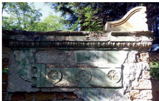
Рис. 11. Декоративный элемент стены южного фасада. Фото И.Н. Слюньковой. 2018 год
