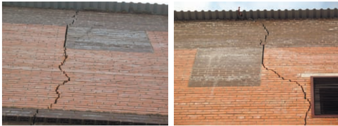
Рис. 1. Сквозные трещины в стенах подстанции
