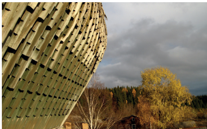
Рис. 6. Благовещенская церковь (1719) в деревне Пустынька. Следы покраски кровли зелёным цветом. Полицы были окрашены красным. Фотография В.И. Казакова
