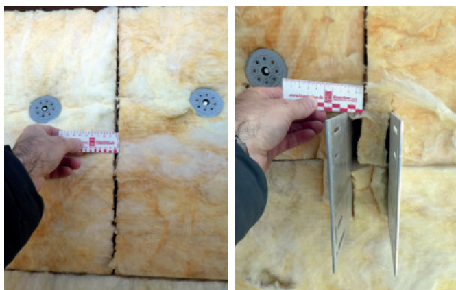
Рис. 1. Примеры некачественного монтажа теплоизоляции в НВФ, зазоры между теплоизоляционными плитами составляют от 5 до 15 мм
